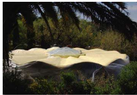
La complejidad de la superficie a aislar no supone ningún inconveniente o retraso.
